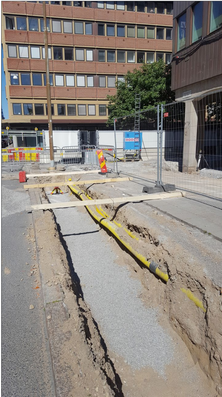
Figur 3. Vy från öster över det längre schaktet i Fredsgatan. Notera ledningarna i den norra schaktväggen (till höger i bild) samt svagt noterbart fjärrvärmekulverten i den södra väggen (till vänster).
