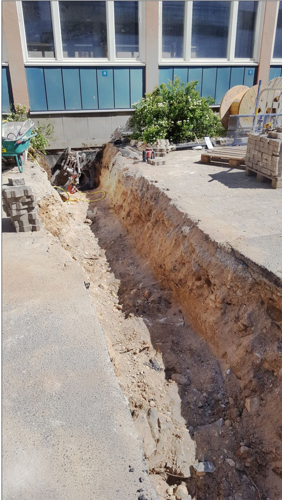
Figur 5. Anslutningspunkten för fjärrkylan mot huset på norra sidan av Fredsgatan. Foto från söder.
