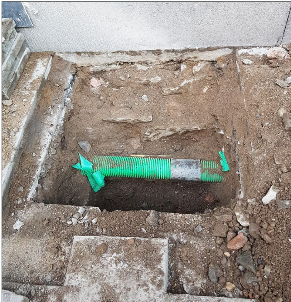
Figur 5. Färdigrävt! I det gröna röret går redan befintliga TV- och elkablar. Delar av sockeln till bostadshuset sticker ut i schaktet. Foto från söder.
