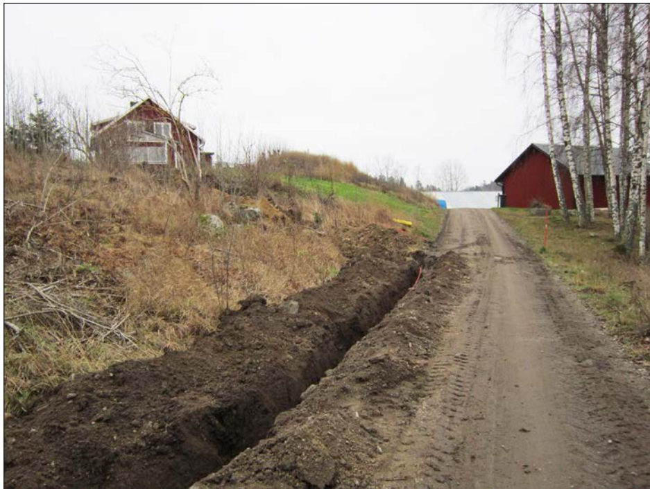
Figur 4. Schaktningen avslutad och kabelnedläggning pågår. Den tidigare garageuppfarten är samma yta som är beväxt av grönt gräs till vänster om vägen. Foto från väster.
