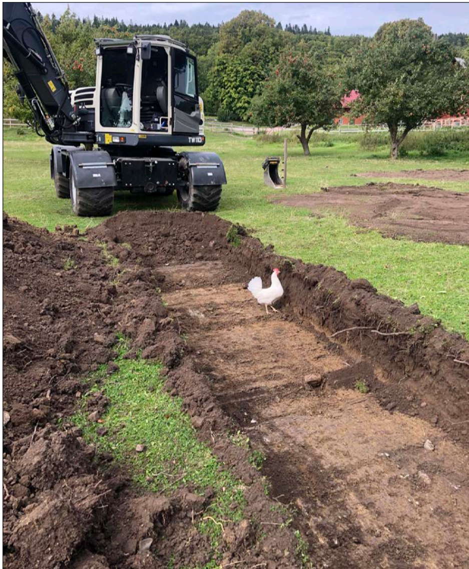
Figur 4. Kackel i schaktet! Foto från söder.
