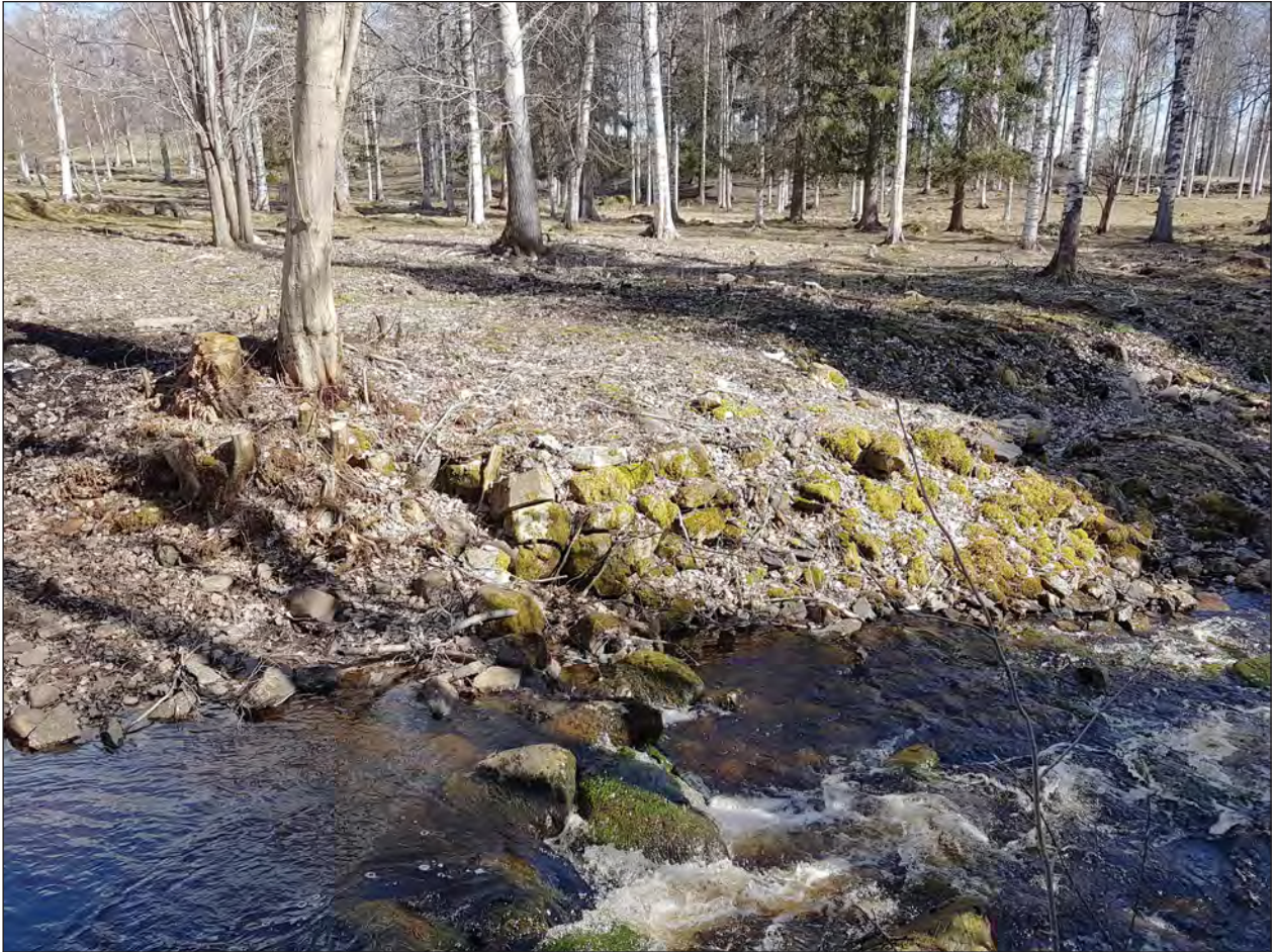
Figur 25. Det norra kallmurade brofästet med delvis utrasade stenar (Objekt 10). Foto från syd.
