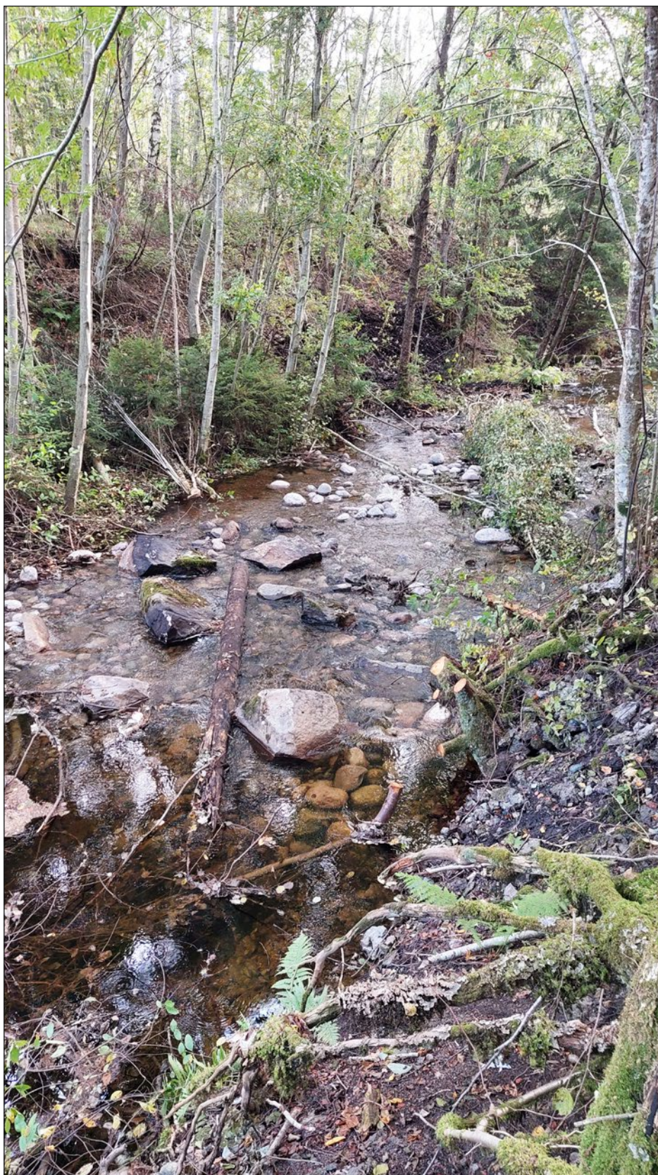
Figur 11. Utfyllnadsmassor i vattendraget omkring 20 meter nedströms vägtrumman. Foto från nordväst.
