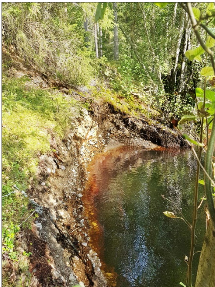
Figur 3. Vid platsen för objekt 1 var vattendragets nordvästra sida uteroderad. Foto från söder.
