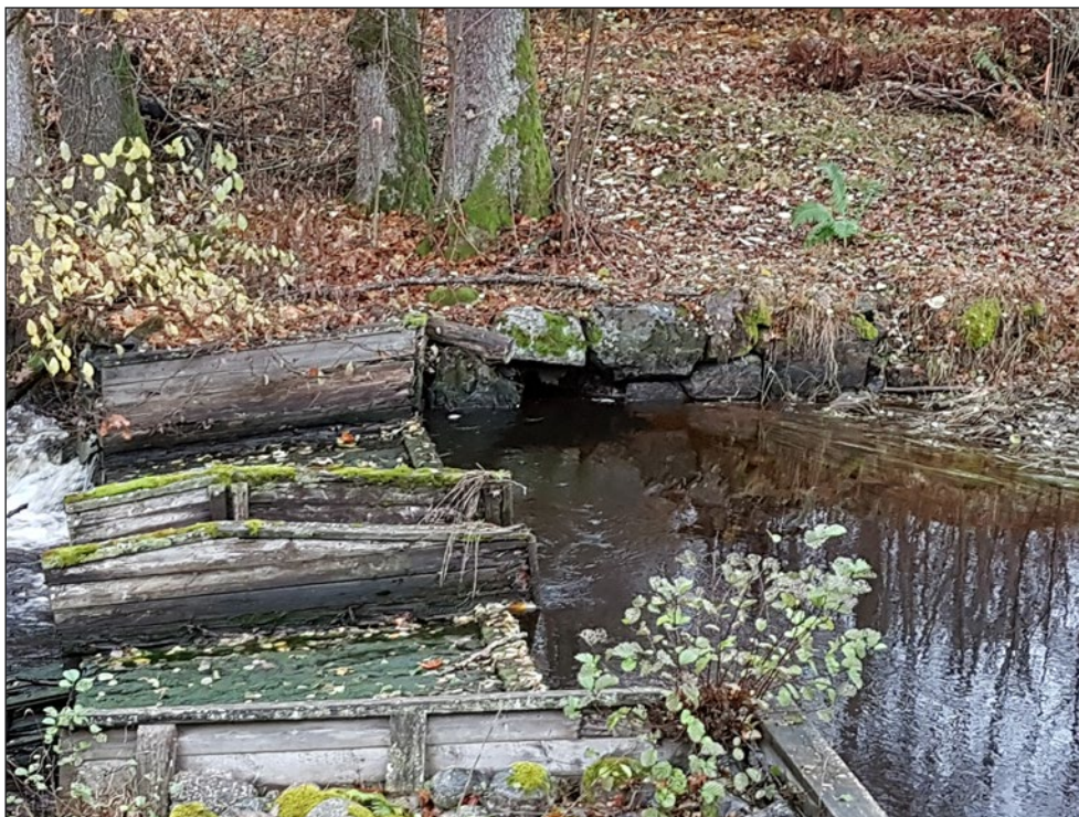
Figur 13. Skadan på kallmurning uppströms grunddammen. Sten från muren har lossnat och vatten tränger in i konstruktionen. Foto från öster.
