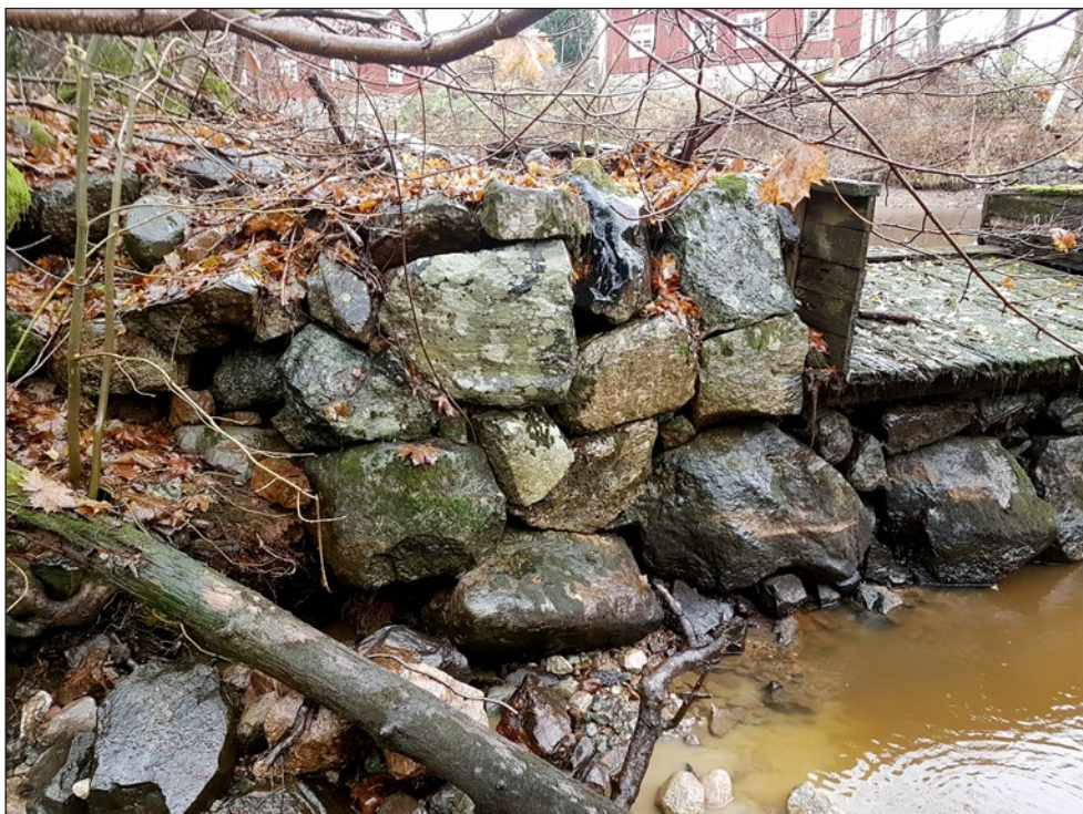
Figur 11. Innan utförd åtgärd forsade vatten mellan fogarna i den sydvästra landarmen. Foto från sydöst i samband med den låga vattennivån under tiden för åtgärdsarbetet.
