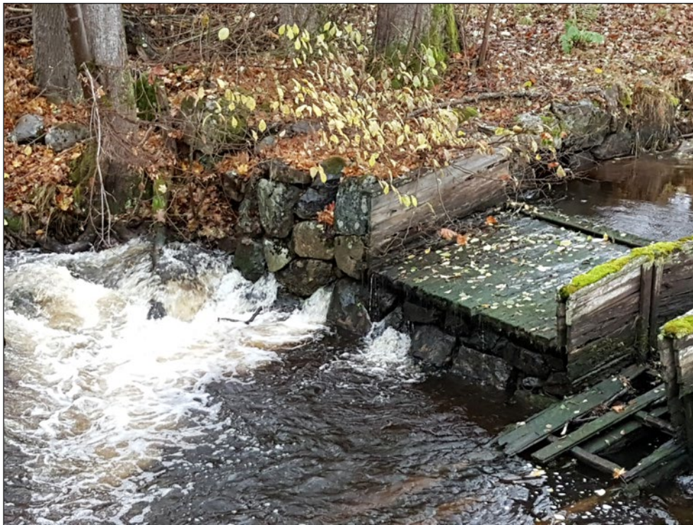
Figur 14. Vatten tränger ut mellan fogarna i den sydvästra landarmens kallmur. Foto från sydöst.
