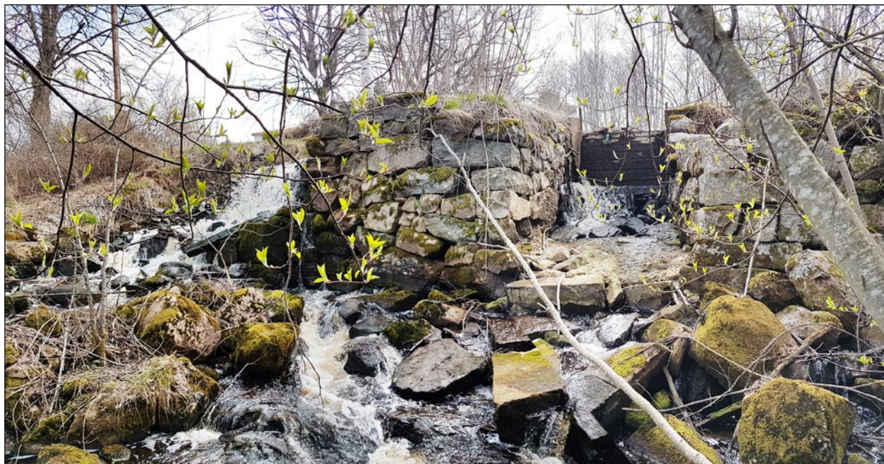
Figur 22. Panoramavy över dammen sedd från sydväst. Dammen har två öppningar. Ett flertal stenar har rasat ned på dammens västra sida.
