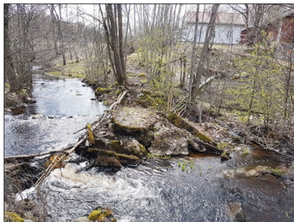
Figur 38. Dammvallen (objekt 15) sedd från norr. Betongskikten har delvis lossnat och rasat ned i vattendraget.
