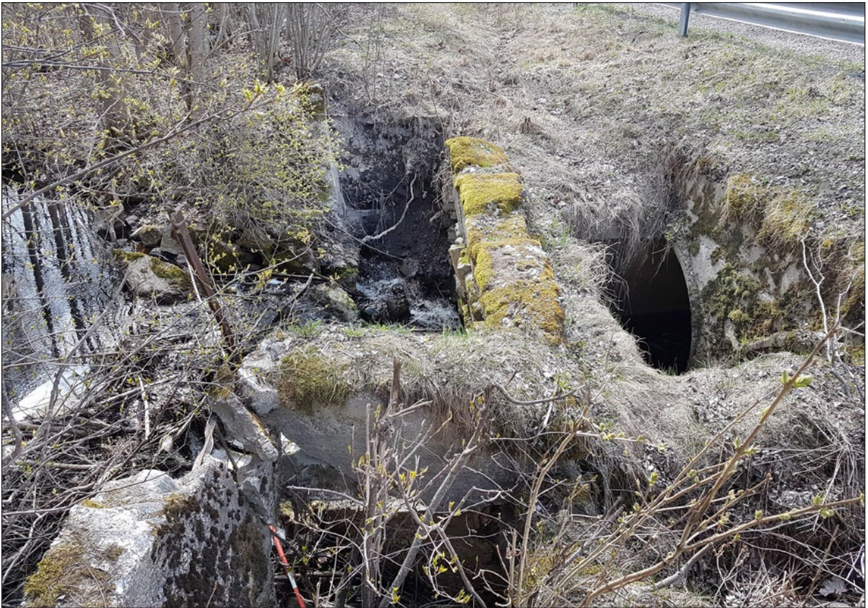
Figur 39. Invid en betongtrumma finns rester efter en damm av betong (tidigare objekt 16). Betongen är sprucken hänger delvis löst. Foto från nordväst.
