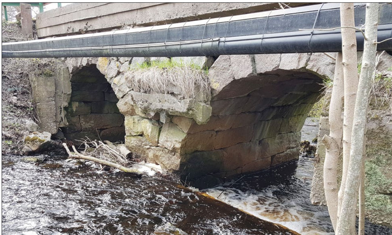
Figur 46. Dammbron (objekt 21) sedd från nordöst. Vid uppströmssidan finns betongrester med gåtspår efter tidigare dammluckor i vardera valvöppning.
