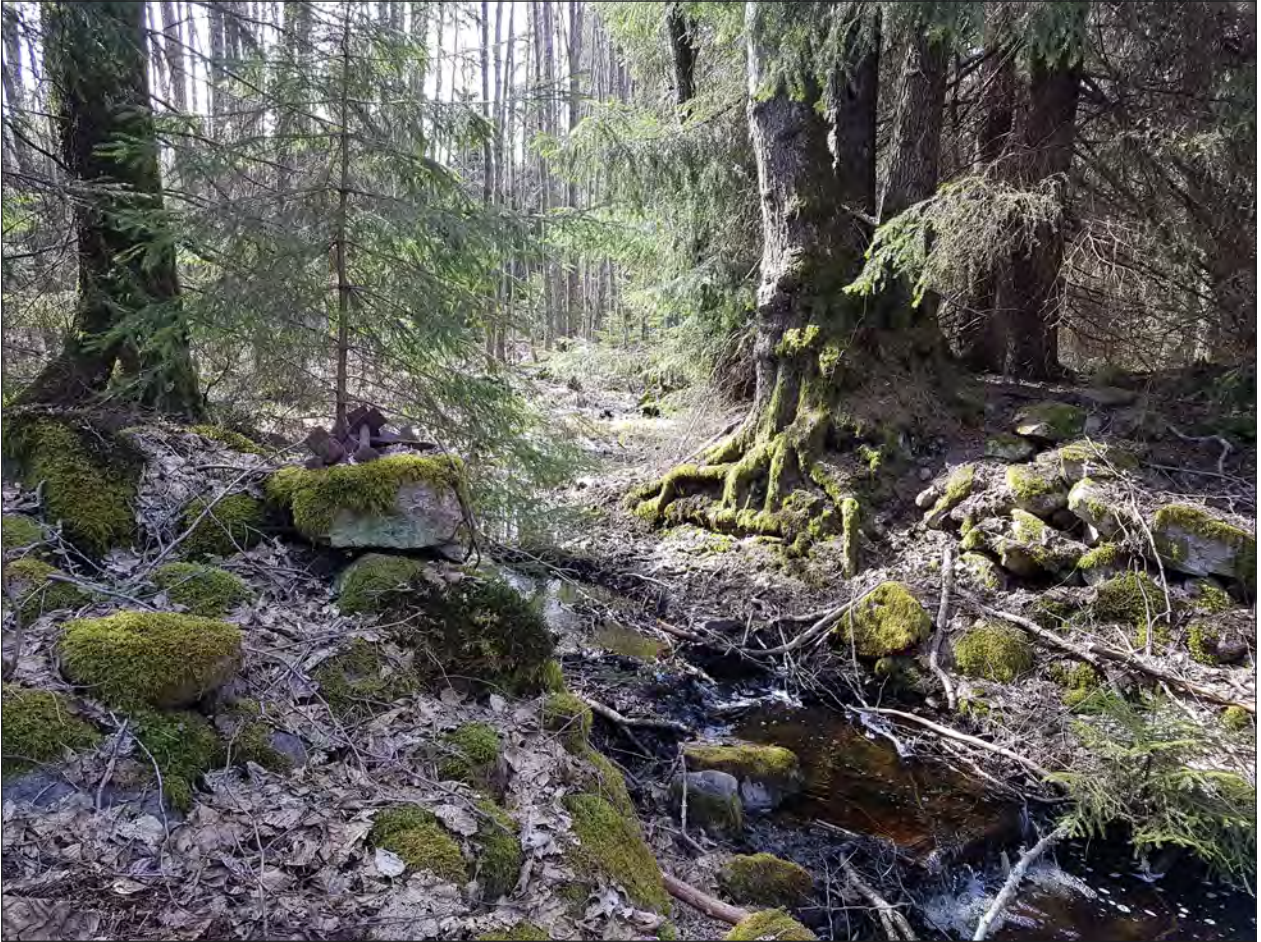
Figur 79. Skepphulta dammöppning. En tidigare dammlucka förefaller ha blivit utriven och järnbultar ligger prydligt upplagda på en hörnsten. Foto från nordöst.
