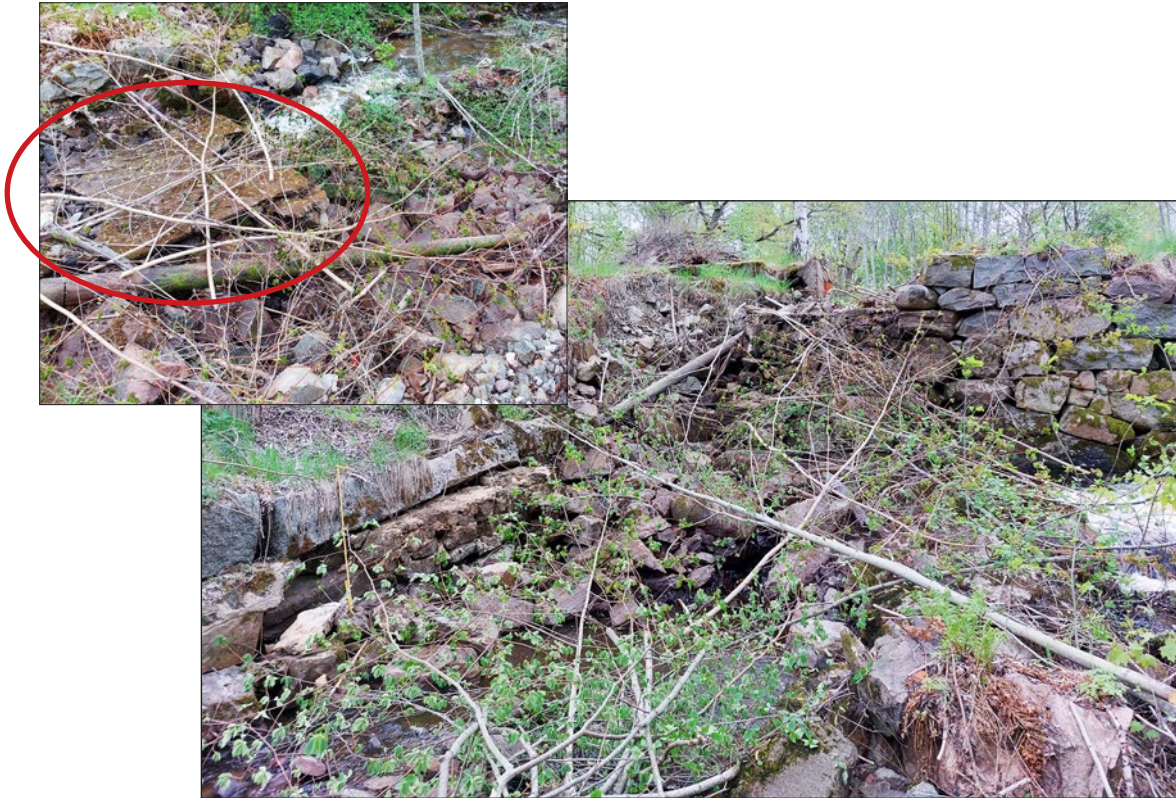
Figur 21a) Det norra landfästet och mittpelaren till höger i bild. Foto från väster. Infällning visar betongplattan som gjutits ovan den kallmurade dammkroppen.
