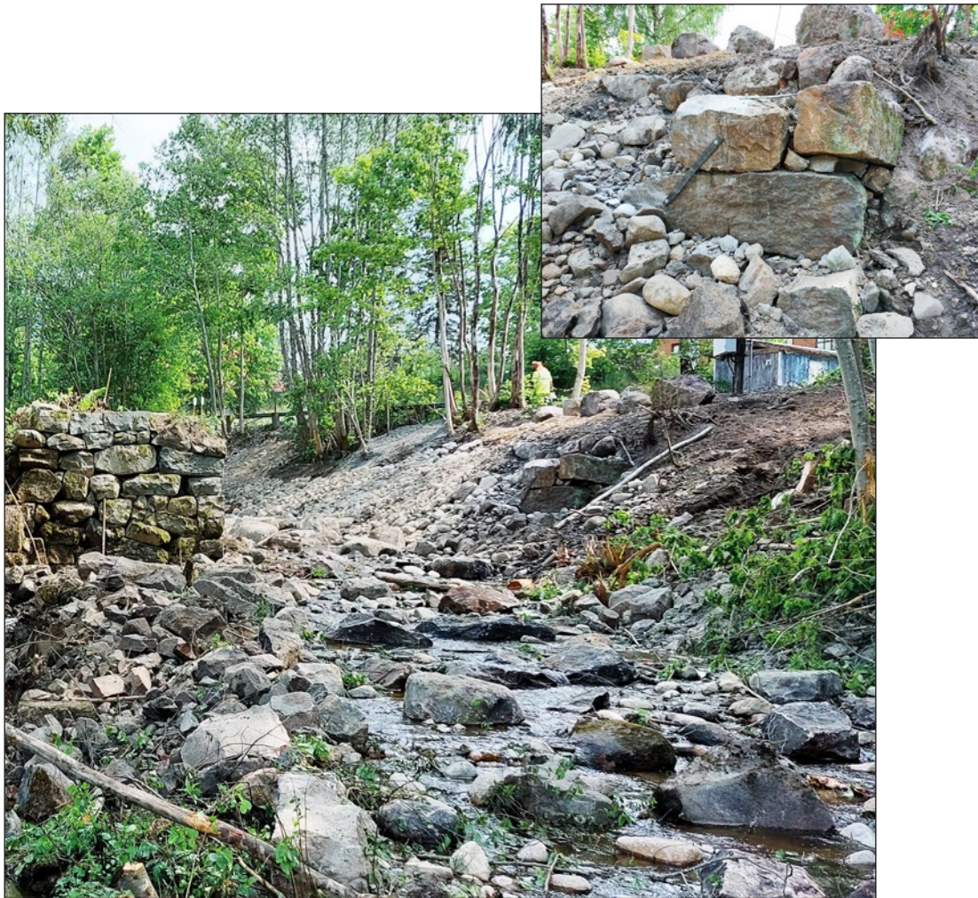
Figur 28. Södra landfästet efter rivning. I infällningen de synliga stenar som kunde bevaras på fästets västra del.
