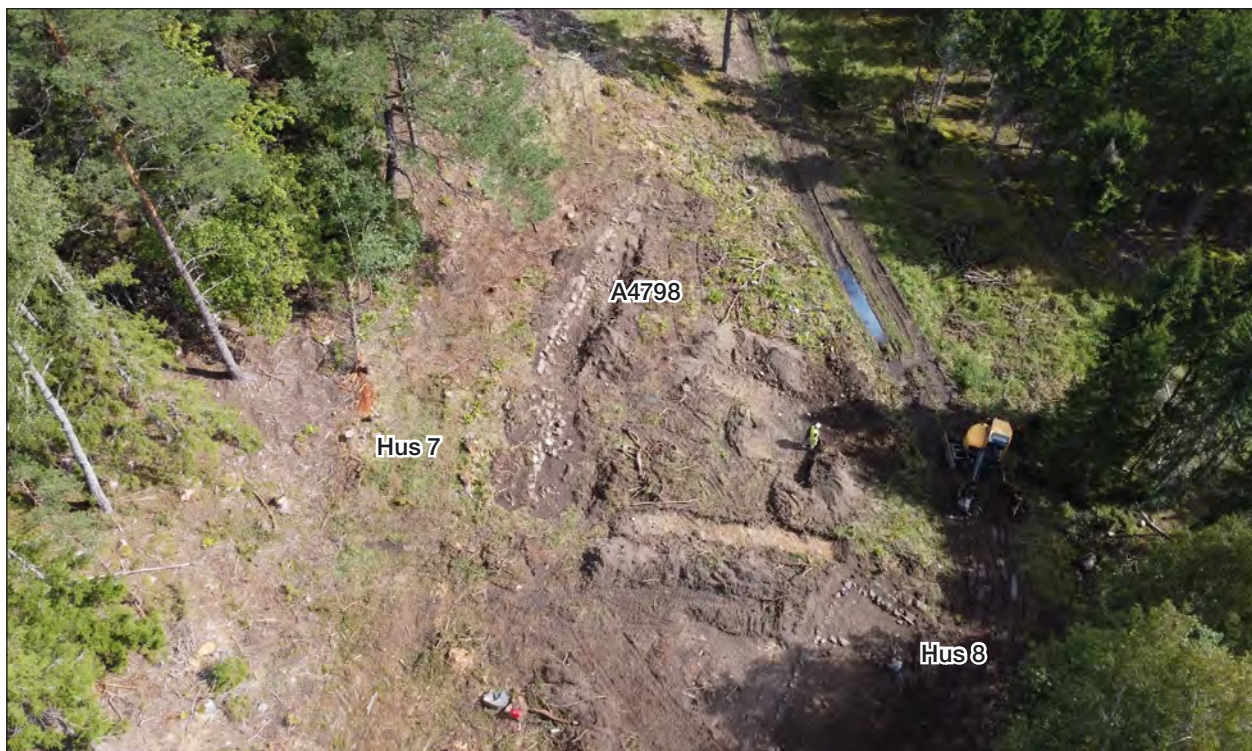
Figur 34. Långbrostugan efter avverkning. I bilden syns schaktningen vid terrasseringen A4798 samt den inledande schaktningen vid Hus 8. Drönarfoto.
