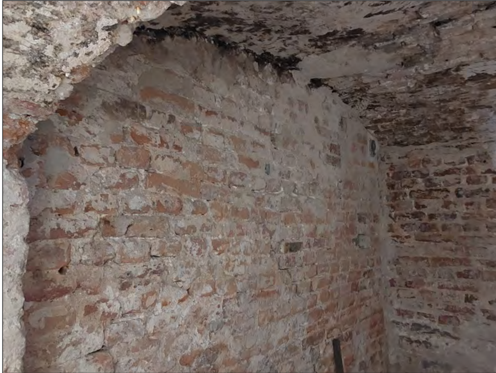
Figur 19. Taket och tegelväggen i rummet intill konstruktionen A1 och A2, på andra sidan den igenmurade öppningen, med sot i taket och på delar av väg-garna. Foto från sydöst.
