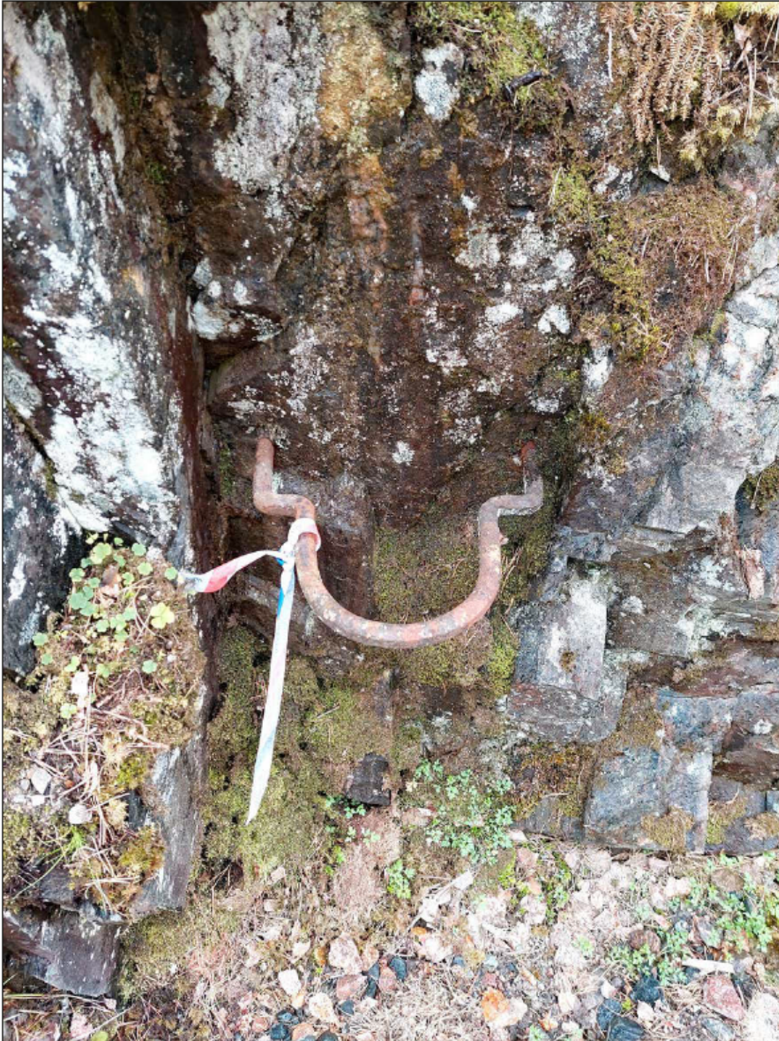
Figur 10. I utredningsområdets sydöstra del löper banvallen, Objekt 2, genom en passage där den sprängts ned genom ett parti berg. Här finns även bevarade järnkrampor, i den sydvästa kanten, vilka använts för att hålla telegrafstolpar. Foto från nordost.
