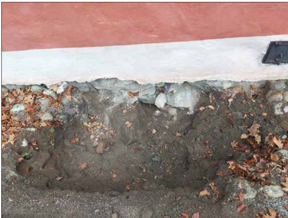
Figur 5. Djupare del av schaktet där marken hade sättningar. Foto från öst.
